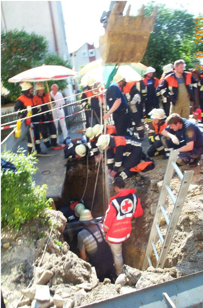
Unfall auf einer Baustelle, Person verschüttet, eine schwierige Rettung, die nach fast zwei Stunden erfolgreich abgeschlossen werden konnte.
